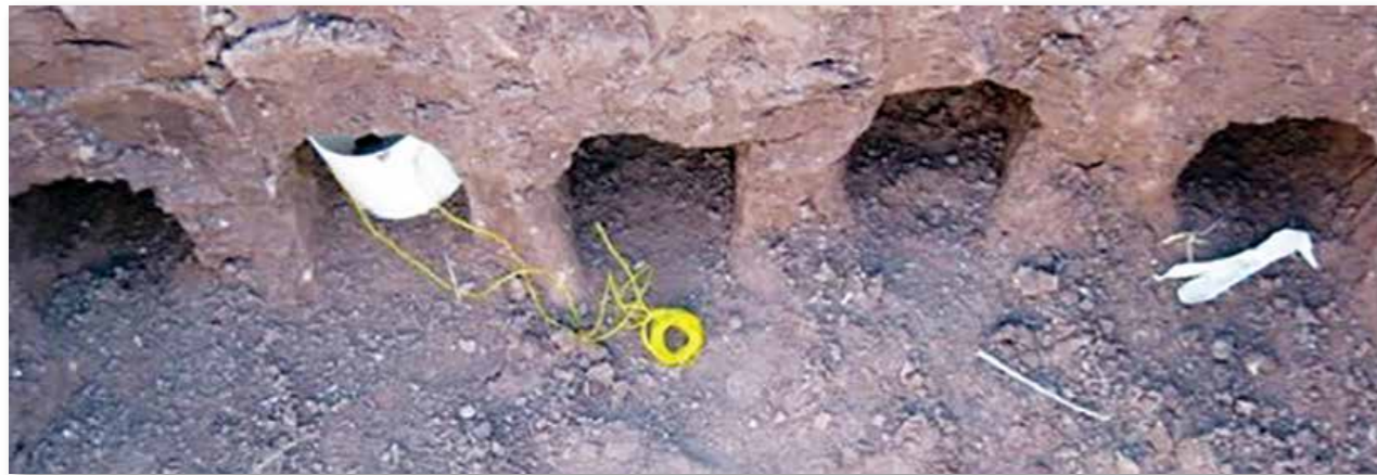
Figura 2. Túneles horizontales hechos dentro de los hoyos listos para la instalación de las cajas de resinas.
